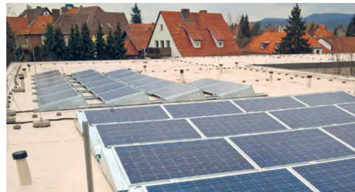
PV-Anlage auf dem Dach des Gesundheitsamtes in Eschwege
